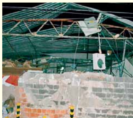
Prédio da empresa veio abaixo com explosão
